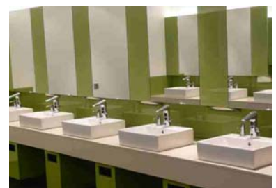
Der öffentliche Bereich des Hotels wurde unter anderem mit elektronischen Armaturen der Serie Ceraplus ausgestattet.
